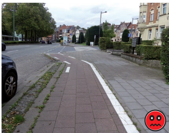
Figure 4 – Boulevard Lambermont – La piste cyclable est rapprochée à hauteur d'un carrefour. Les places de stationnement auraient dû être supprimées 15,00 à 30,00m avant le carrefour pour garantir une bonne visibilité.
