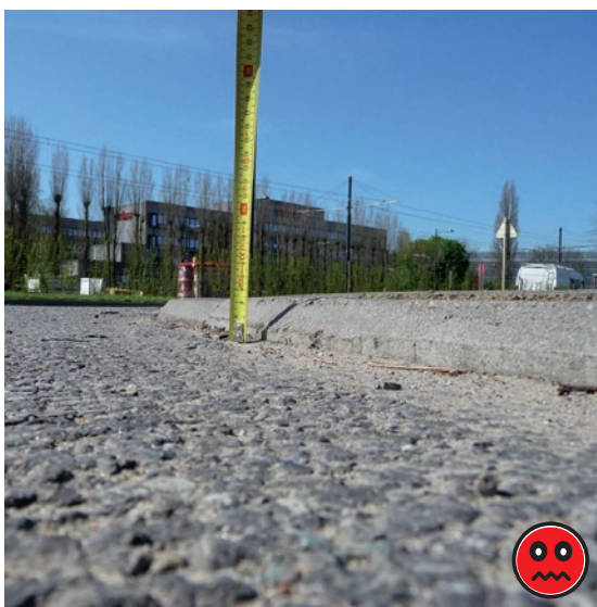
Figure 9 – Boulevard Léopold III, bordure – ne permet pas aux cyclistes de monter ou descendre de la piste cyclable en toute sécurité.
