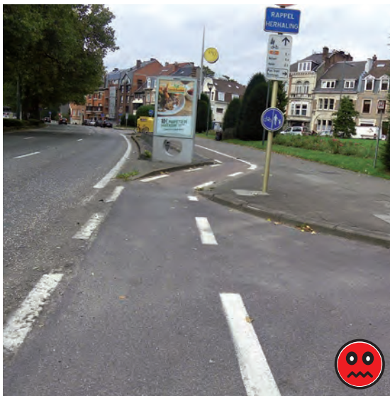
Figure 45 – Boulevard Lambermont – Mauvais déplacement d'axe.
